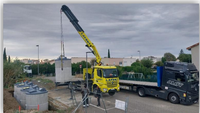
Travaux Donzère Point d'apport volontaire complet
